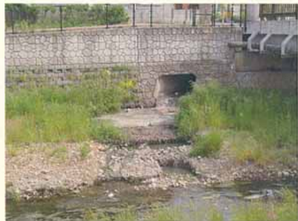
清水橋右岸の排水口。水が汚く見た目に悪い。
