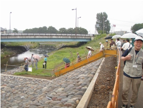
柳瀬川・空堀川合流点下流側 河川工事現場下流の河川敷に降りる。
