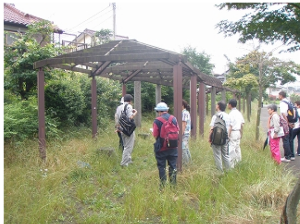
空堀川 右岸芝生広場 芝生広場内のパーゴラの状態を確認。
