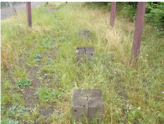
空堀川 右岸芝生広場 パーゴラ下の腰掛けの状況。
