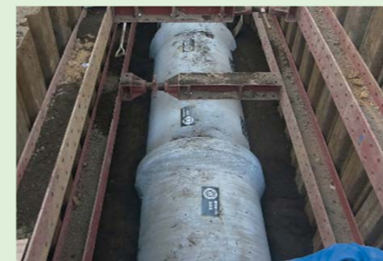
写真 排水管工事の状況 (上左:工事後(H25.6)、上右と下:施工中の状況)
