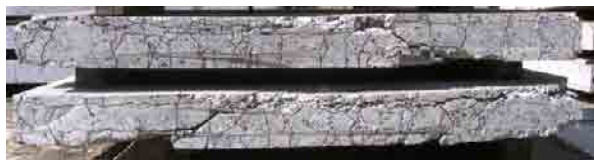
(a) 東京都 主筋切断面
