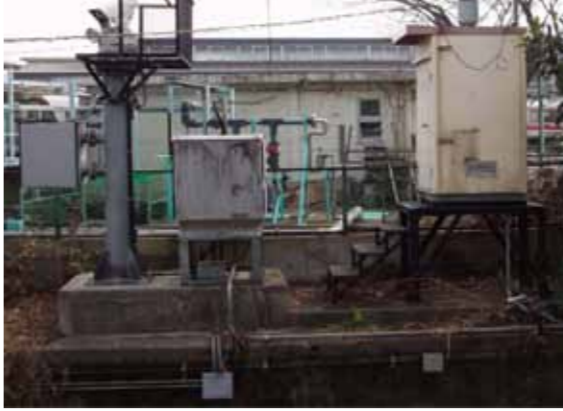
雨量計・観測局舎(神善合流監視局)
