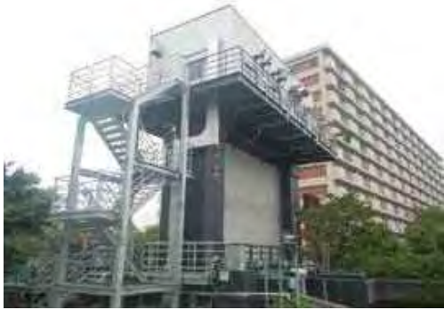
内川水門(大田区大森東三丁目地内) 大地震発生直後でも津波・高潮に対して確実に扉体が閉じて、堤防機能を確保できるように整備。「水の都江戸」を感じさせるような景観への配慮。
