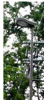
車道照明（LED）
