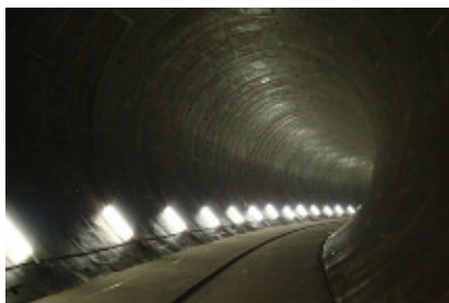
白子川地下調節池 (整備中) (内径10.0m、貯留量約21万m 3 )
