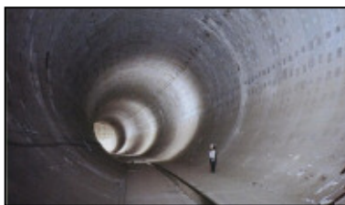
神田川・環状七号線地下調節池 (整備済) (内径12.5m、貯留量約54万m 3 )
