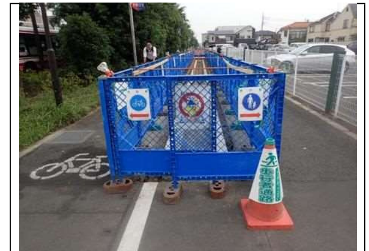
現場で得られたやりがいや達成感 わかりやすい規制帯の設置
