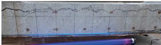
写真-7 PL-4の上鉄筋位置の水平ひび割れ
