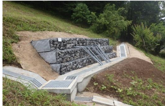
地すべり防止施設
