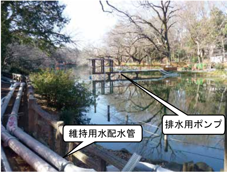
写真 2. ポンプ吊り下げ台と弁天池からの送水配管
