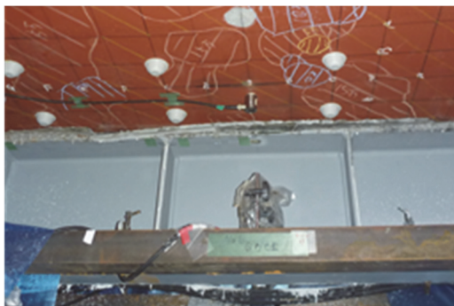
写真-4 PL-6 横桁上面シール材のはみ出し
