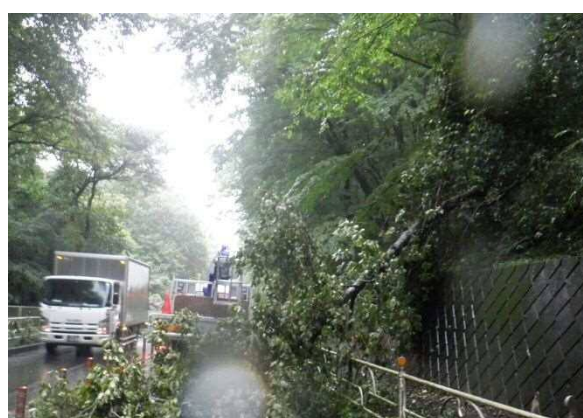
倒木による被害の状況
