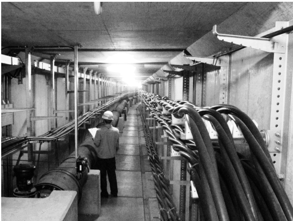
立川共同溝内部
