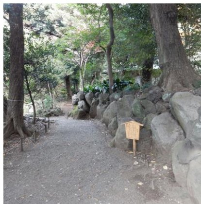
図 2 - 106 S : 崩れ石積の景観 平成 30 (2018) 年 12 月 10 日
