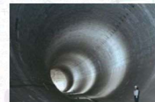
環状七号線地下調節池
