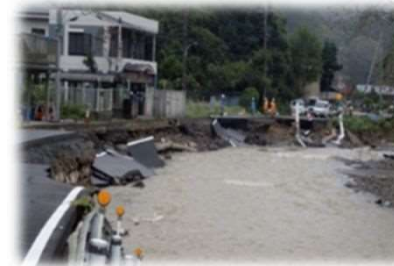
護岸損壊に伴う道路崩落（平井川）
