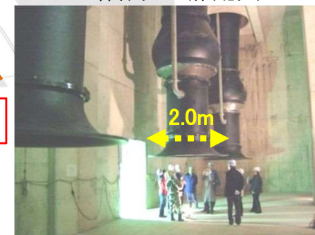
図-2 雨水ポンプの例 神谷ポンプ所(北区)
