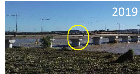
2019 令和元年台風第19号で洗堀被害
