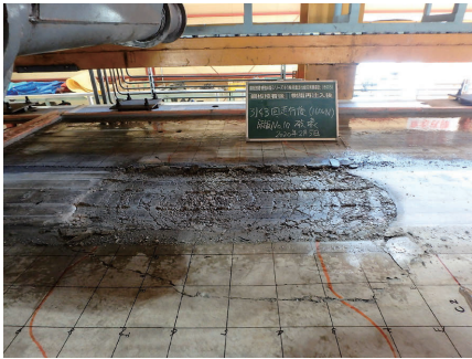
写真-7 PL-10の破壊状況
