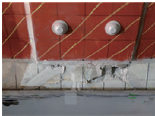
写真-4 PL-9 鋼板端部ハンチの破壊
