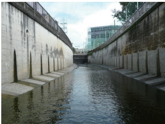
写真-12 呑川 境橋付近
