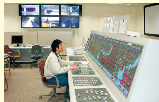
善福寺川取水施設・中央監視操作盤
