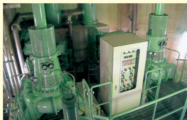
善福寺川取水施設・主排水ポンプ
