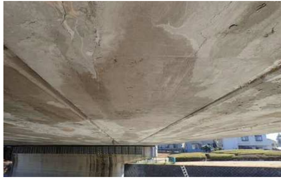
アルカリシリカ反応や雨水による主桁コンクリートのひび割れと漏水
