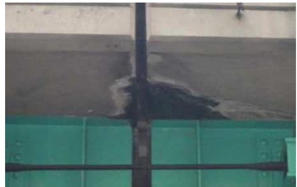
写真3-2 RC床版、端部張り出し部の損傷事例
