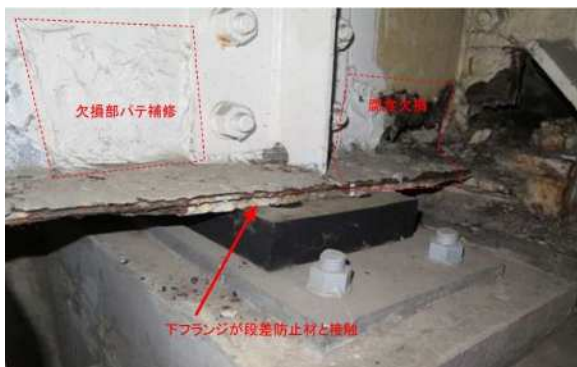
写真3-1 鋼桁端部の損傷事例
