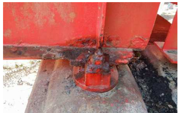
雨水による鋼支承や鋼桁端部の腐食
