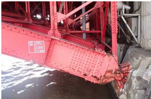
海水による鋼アーチ部材の腐食
