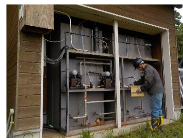
バイオトイレの点検の様子
