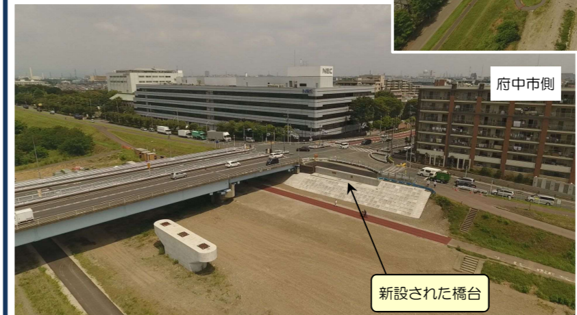
【写真下】 6年目工事完了状況（府中市側） 府中市側に新しい橋台が新設されました。
