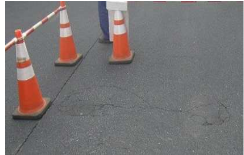
写真-1 ひびわれ状況
