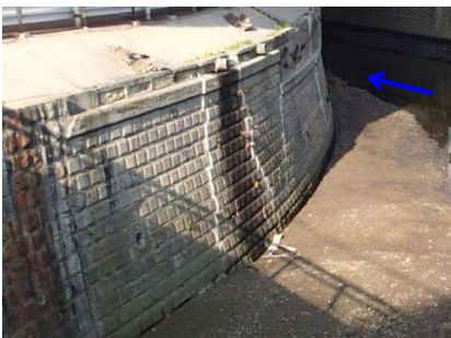
護岸の老朽化(古川)
