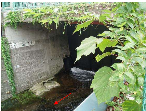
写真 2-2 総武線の馬喰町、東京駅にろう出している地下水導水の様子（月見橋）
