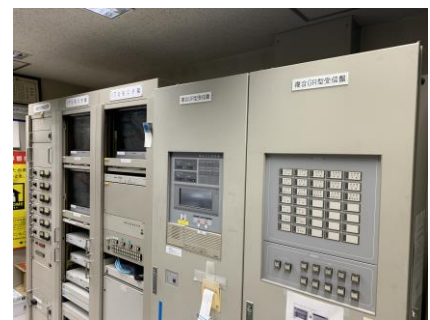
写真－2 中央監視設備
