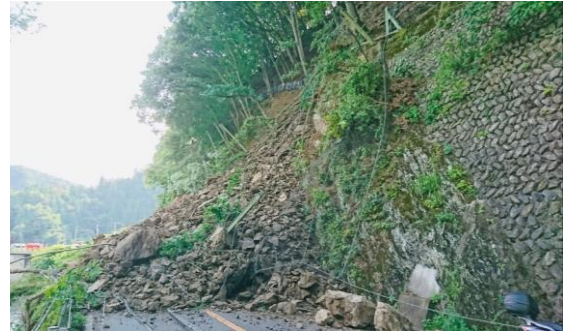
写真－1 被災直後の様子
