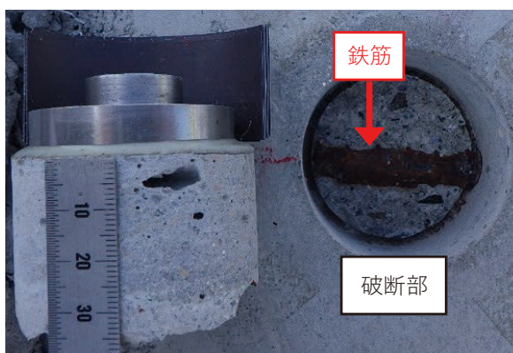
写真-6 鉄筋影響箇所（増厚材B）
