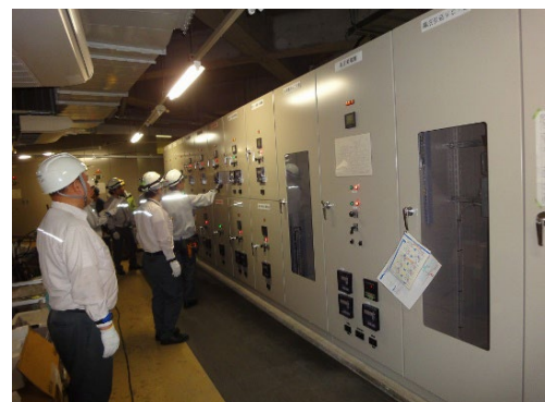
設備の保守点検作業
