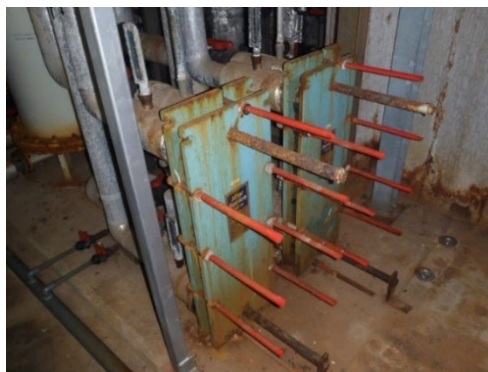
更新対象の老朽設備（水槽熱交換器）
