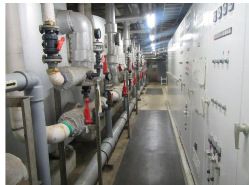
水処理等の設備群
