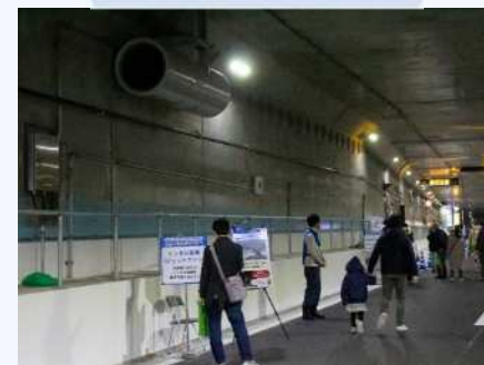
防煙設備(ジェットファン)
