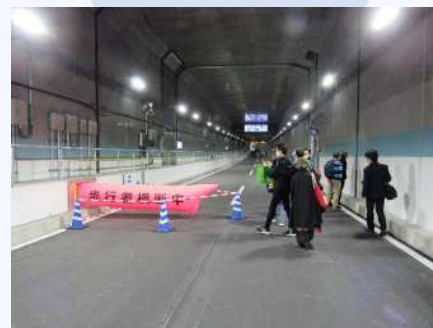
防災設備(エア遮断機)
