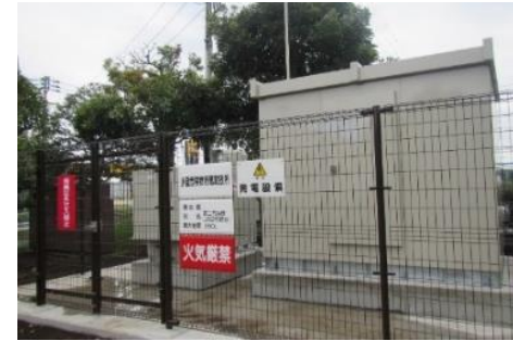
災害に備えた非常用発電機
