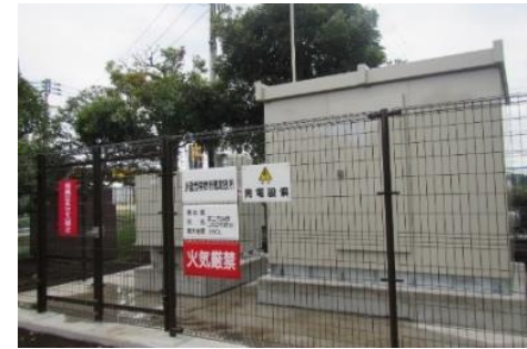
災害に備えた非常用発電機
