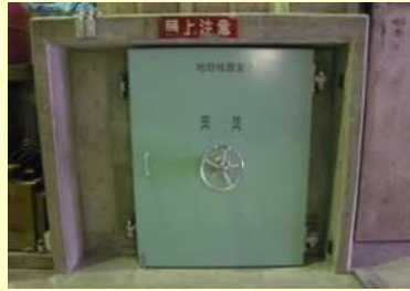
排水機場の耐水対策例 (防水扉の設置・木下川排水機場)
