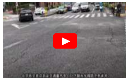
図-3 PR 動画（路面の劣化状況）
