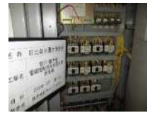
電灯動力盤電磁接触器
