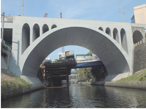
橋梁の長寿命化事業 (聖橋:千代田区神田駿河台四丁目～文京区湯島一丁目) 神田川に架かる聖橋は、耐震性や耐久性などの向上を図る長寿命化事業を実施した。
