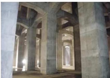
地下箱式 (善福寺川調節池)
