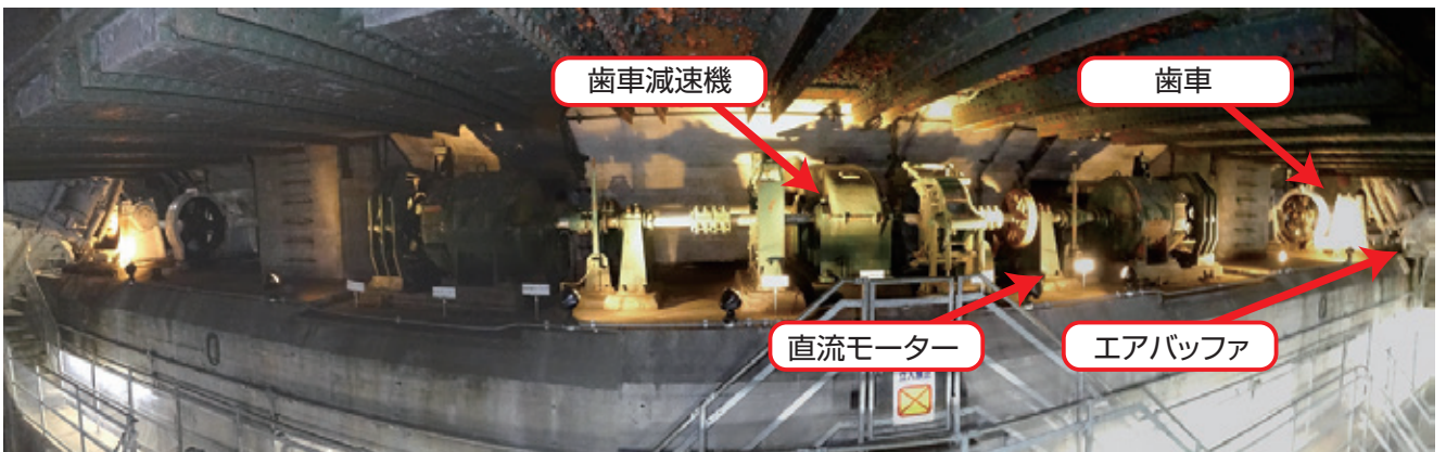
勝鬨橋橋脚内部の機械室
