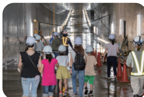
令和4年度 親子体験ツアー トンネル工事現場(雑司が谷)を見学する様子
