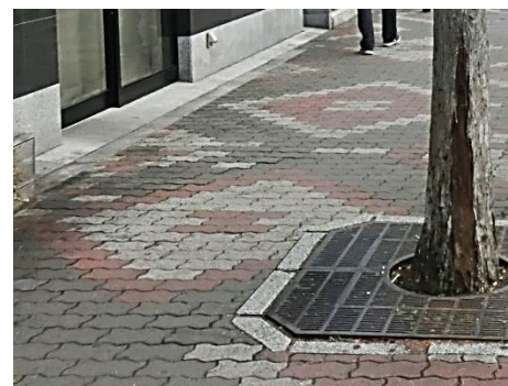
写真4.12.1 根上がりによるインターロッキング舗装のがたつき
