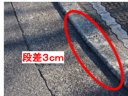
写真4.2.1 歩車道境界の段差
