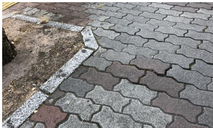
写真4.3.1 根上がりによる舗装のがたつき
