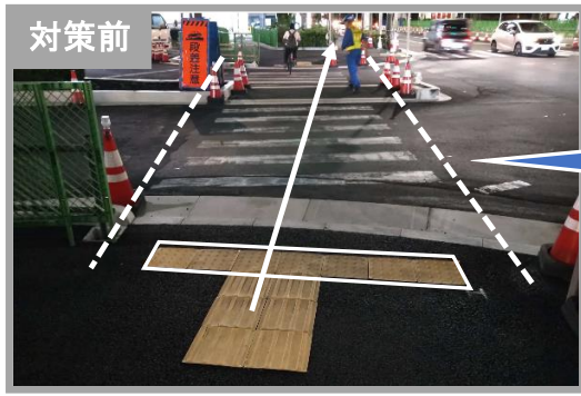
写真5.1.1 横断歩道の中心とずれている 線状ブロックの向き
