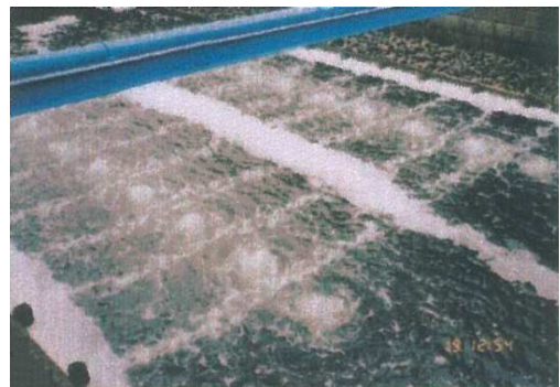
(水質浄化装置稼働状況)
