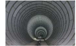
神田川・環状七号線地下調節池（杉並区）
