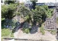
かけ崩れから人家を守る法枠工 (青梅市 河辺町一丁目地区)
