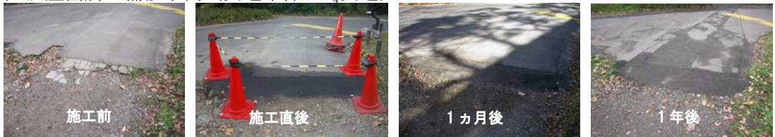
写真-2 段差箇所の経年変化
