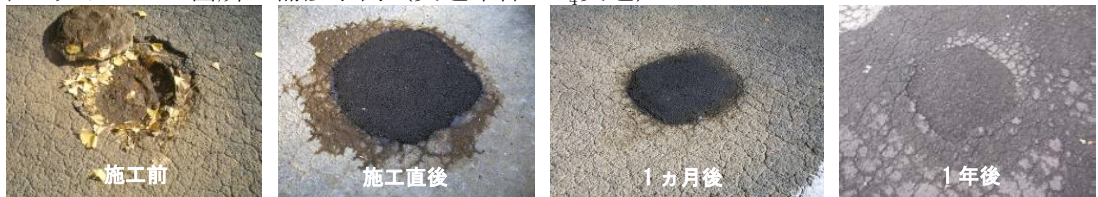
写真-1 ポットホール補修箇所の経年変化
