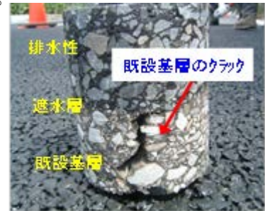
写真-4 現場採取コアの状況
