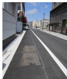
【図 5：車道幅が狭く歩道部分に車が乗り入れてくる様な所に施工された例】
