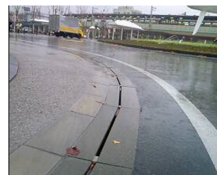
写真-6 連続したスリット集水 集中豪雨時
