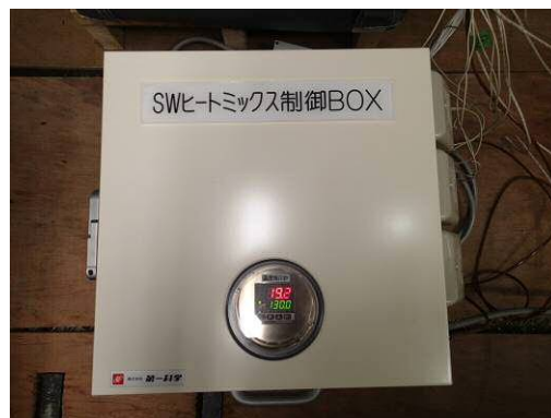
写真-5 制御BOX
