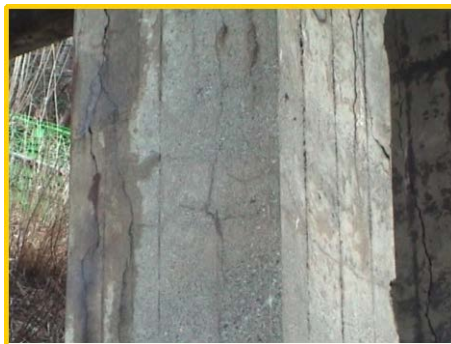
脱塩を適用しなかった橋脚の状況 旧国道8号線洞川橋経年比較
