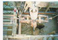
大変形時の杭と地盤の状況
